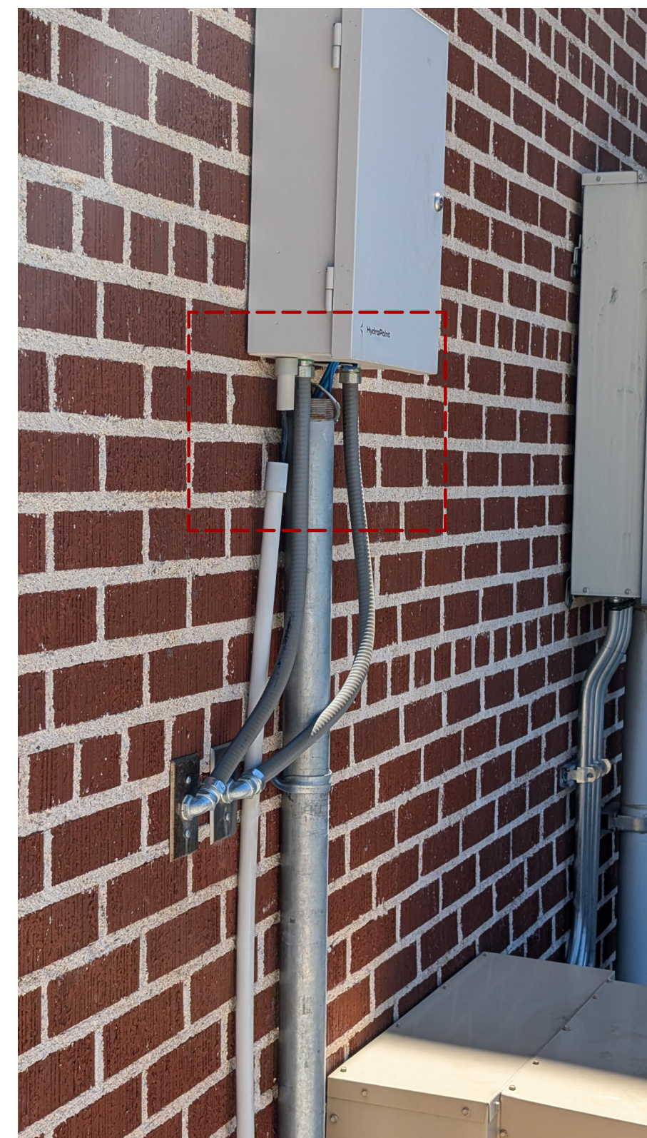
A3 SPRINKLER CONDUIT SEPARATION
